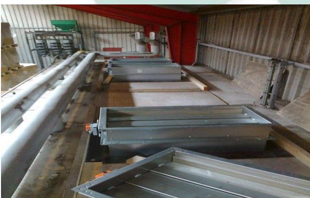
Vue de haut du séchoir existant; Installation des volets d'admission pour l'air séché.
