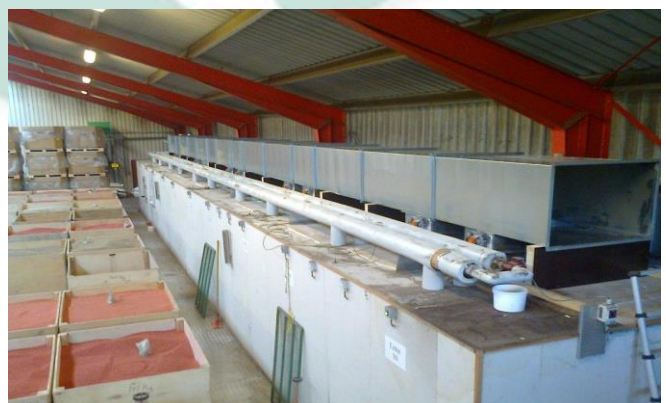
Canal de répartition d'air sur les volets d'admission. L'air séché du déshumidificateur va vers chaque section.
