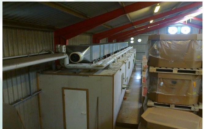
Installation après transformation; un canal central avec un jeu de volets par rangée / section.
