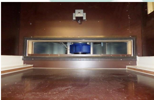
Un ventilateur haute pression avec une sonde de «Flux» pour chaque emplacement.
