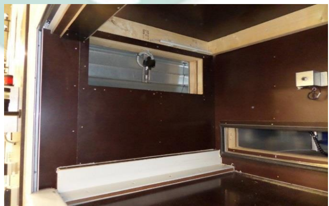
Sortie d'air avec sonde T° et HR pour les mesures du process.
