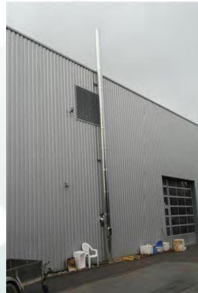
Aspiration de l'air frais à travers un canal central par une bouche d'aspiration grillagée dans le mur.
