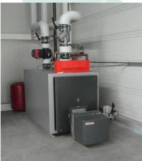
Exemple de chaudière pour le chauffage des deux sections.
